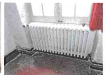
Radiateur de chauffage
