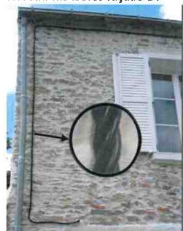
Réseau fils isolés façade BT
