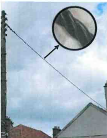
Réseau fils isolés aérien BT
